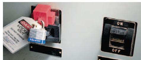
Bloqueio para disjuntores grandes
